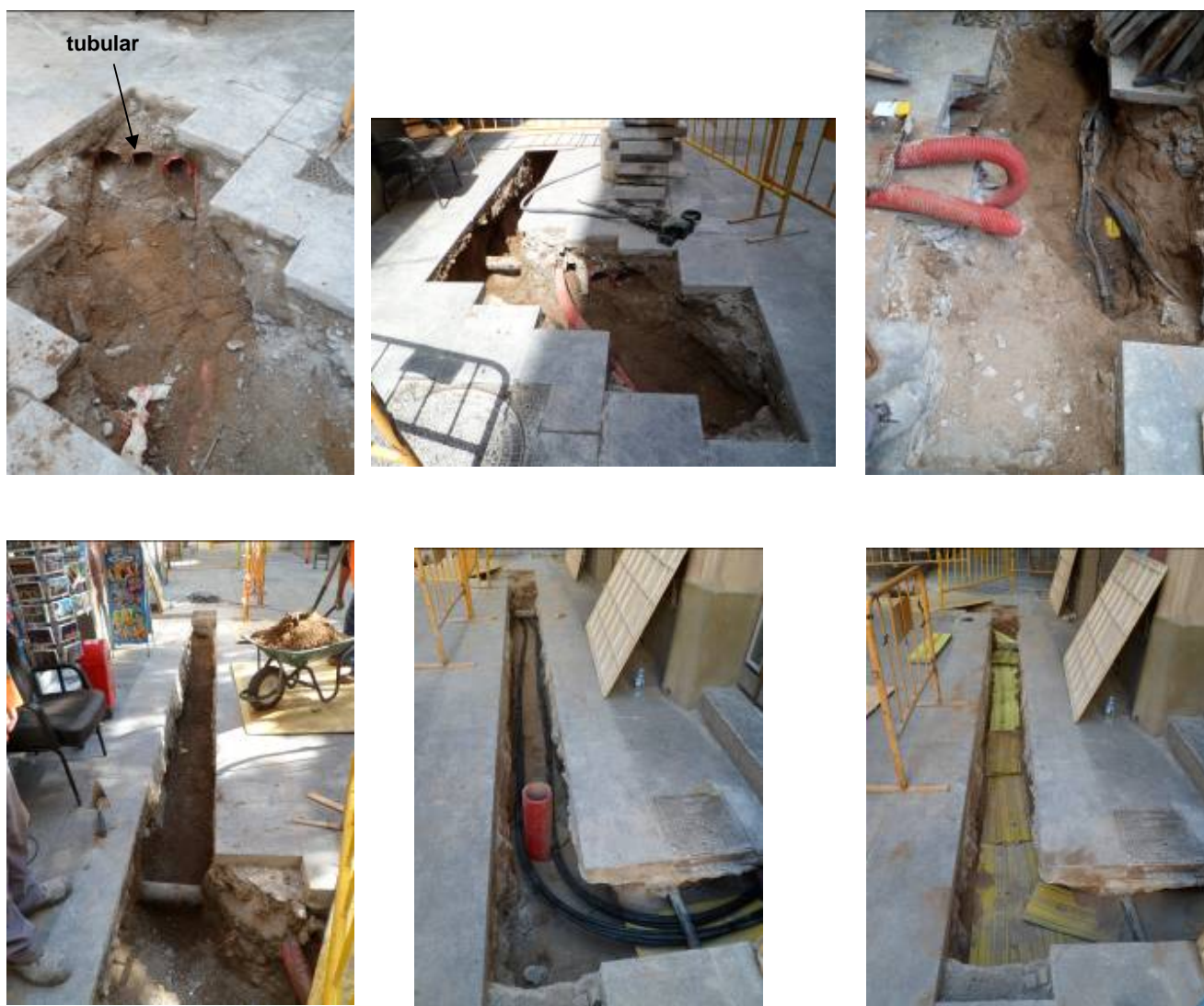
Fig.12.- Rasa 100: diverses vistes dels treballs .Aparició xarxa elèctrica actual i nova escomesa
